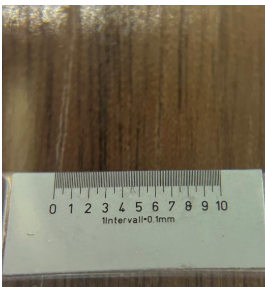
Abbildung 13: Messung der Rissbreite
